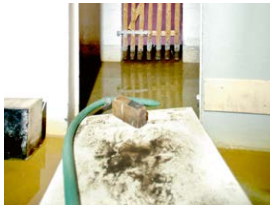
2011 Wasser im Kellergang
